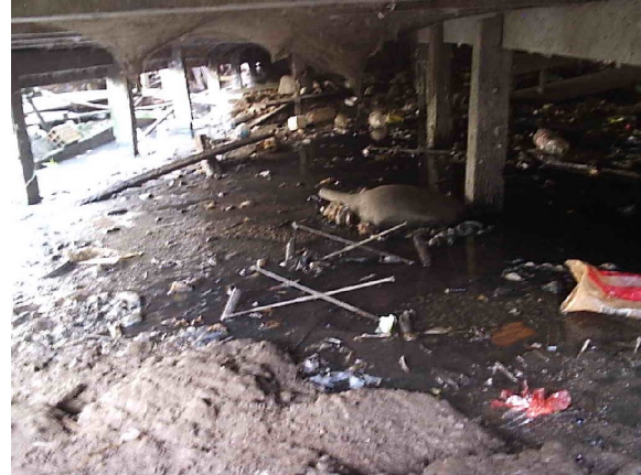
Figura 40 – Esgoto sanitário em residência do Riacho Doce. Fonte: Direta, 2007.
