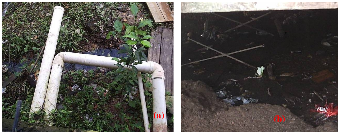
Figura 36 (a) – Ponto de lançamento de efluente no quintal e, (b) Lançamento na parte inferior da residência.
