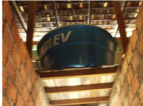
Figura 35 - Caixa d'água no interior de uma das economias pesquisadas Fonte: Direta, 2007.
