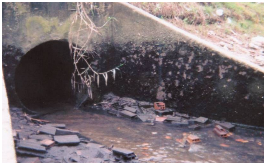
Figura 37 – Ponto de lançamento dos efluentes no Igarapé Tucunduba. Fonte: Direta, 2007.
